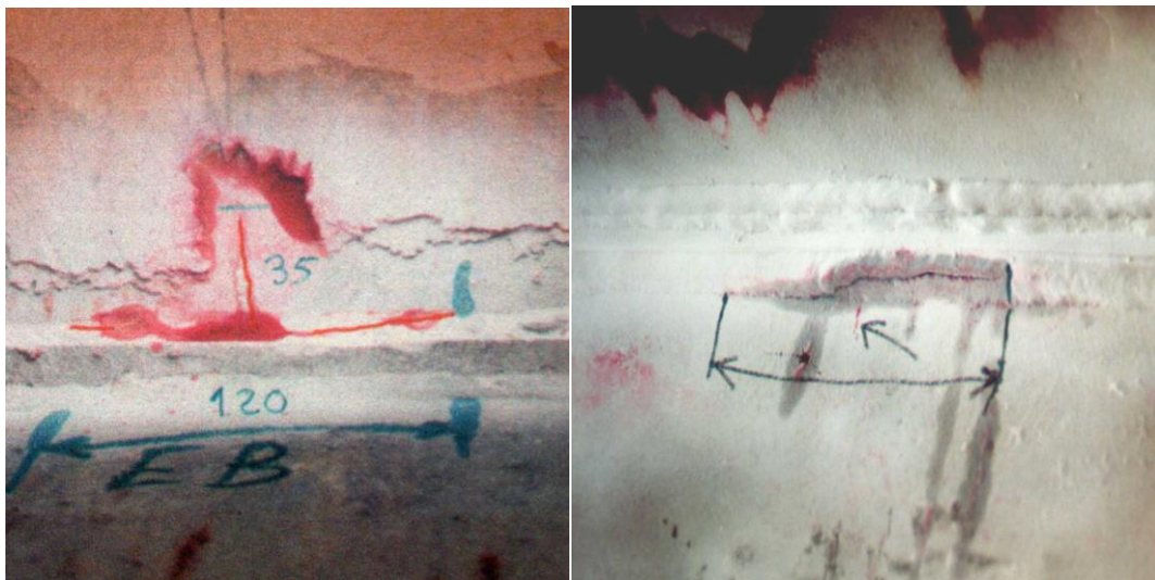
a) b) Figura 2.1 Fissura a) No cordão de soldadura entre o casco e a chapa sobreposta. b) Entre a chapa sobreposta e o robalete.
