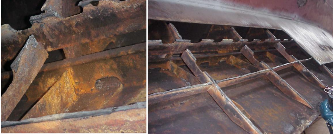
Figura 2.2 Inspeção à estrutura interna dos robaletes, fracturas na ligação entre os reforços longitudinais e transversais.
