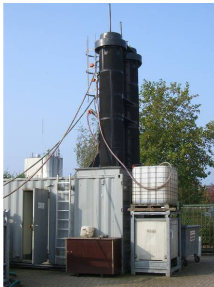
Figura 3.32 – Instalação piloto da ETAR de Epe
