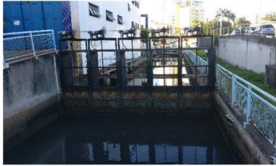
Figura 5-19 B: Estação de bombeamento de Bento Ferreira
