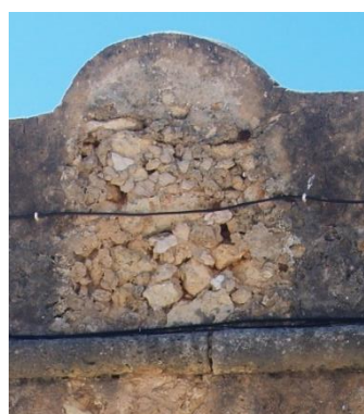
Figura 67 – A UEM [17] localizada na ausência do reboco. ©Bruna Galamba, 2021.
