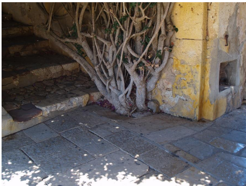
Figura 115 – Nesta fotografia é possível observar as raízes de uma das plantas/árvores a Oeste a levantar o chão e a danificar a estrutura por trás.
