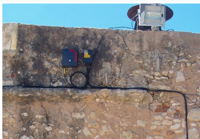
Figura 96 – Vários equipamentos e cabos de eletricidade presos no meio-baluarde Oeste. ©Bruna Galamba, 2021.
