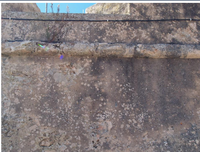
Figura 61 – A UEM [7] é um reboco que se encontra disperso pela fachada. Nesta seção, no meio-baluarde Este, encontra-se em melhores condições. ©Bruna Galamba, 2021.
