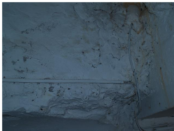
Figura 118 – Nesta fotografia é possível observar a espuma de isolamento e infiltrações dentro do meio-baluarde Este.
