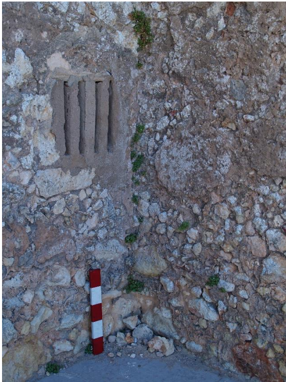
Figura 113 – Nesta fotografia é possível observar pedras que já caíram da alvenaria e a presença de várias plantas.
