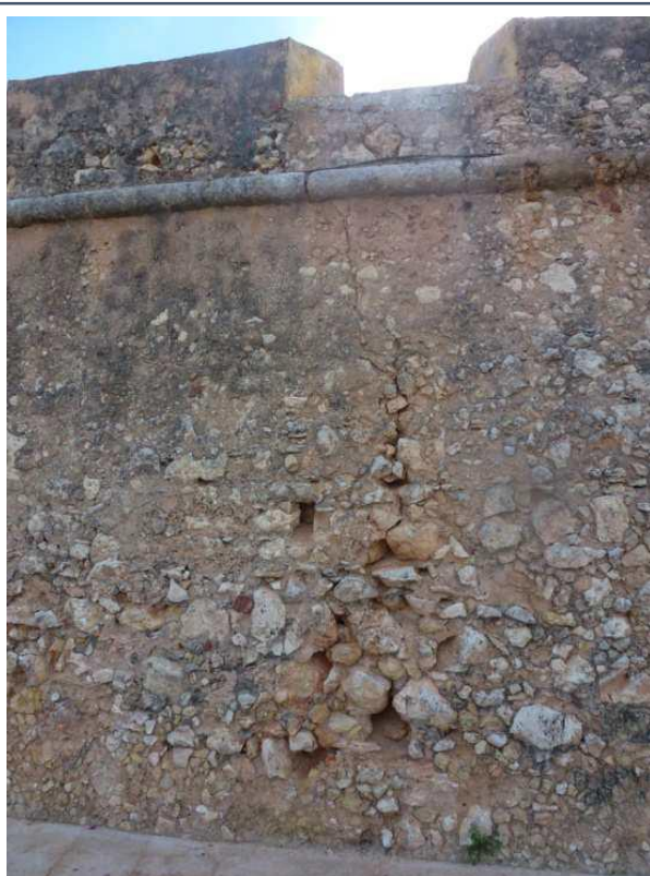
Figura 109 – Falha no meio-baluarte Oeste, localizando-se a falta de argamassa e queda de pedras (PINTO, 2017, :5).
