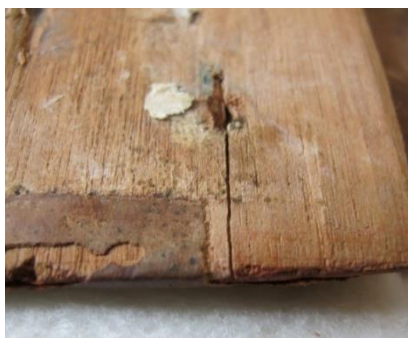
Figura V.1 -Fissuras e aspeto desidratado da madeira
