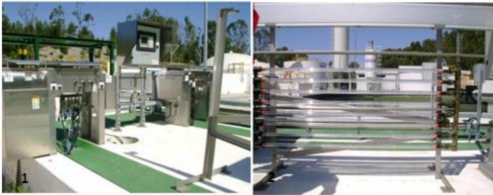
Figura 5.3 - Sistema de desinfecção instalado na ETAR de Fernão Ferro 1-Sistema de controlo da desinfecção UV ; 2-Modulo de lâmpadas UV presente no canal
