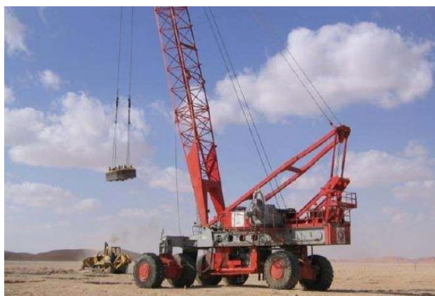
Figura 2.2 - Compactação dinâmica usando um tipo de plataforma de fácil montagem (produz energias de impacto até 7 MNm) (Hamidi 2014).
