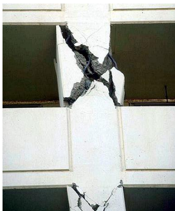
Figura 2.9 Rotura por corte num pilar (kobe 1995) [ACE-MRL]
