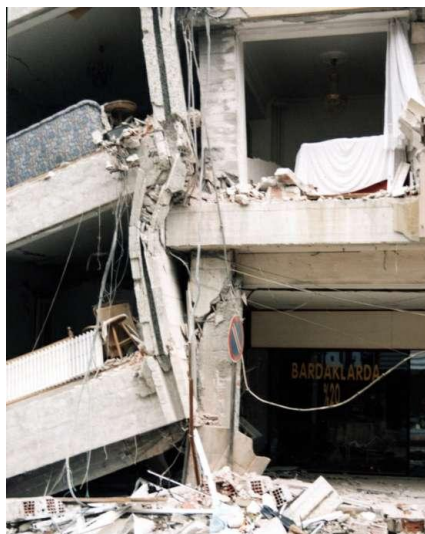
Figura 1.3 Juntas sísmicas inadequadas (Turquia, Kocaeli 1999) [IISEE]
