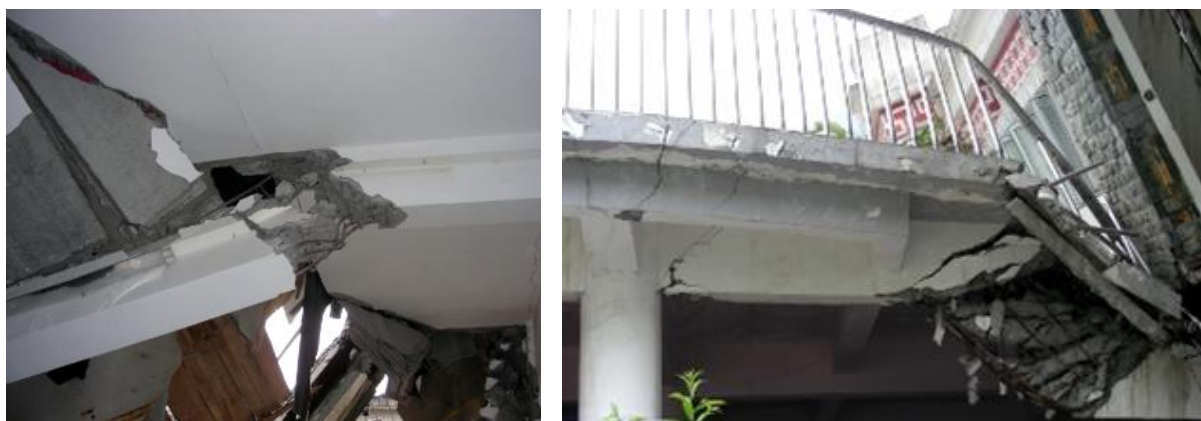
Figura 2.12 Rotura da viga por corte (China, Wenchuan 2008) [NEES-Anchor]
