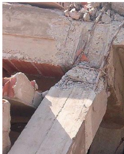
Figura 1.6 Rotura do nó por falta de cintagem (China, Wenchuan 2008) [Foundation, Concrete and Earthquake Engineering]
