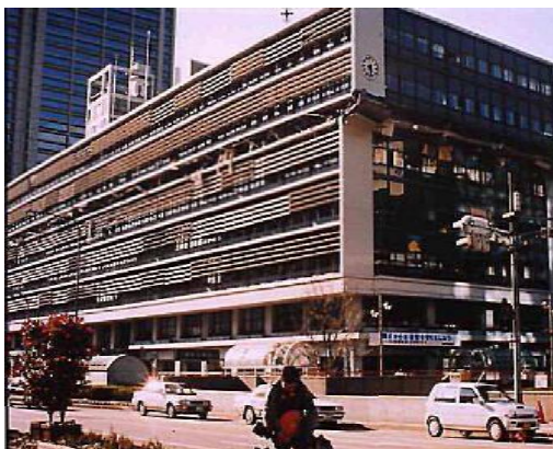
Figura 2.7 Irregularidade em altura: Colapso de um piso intermédio devido a redução da rigidez (Kobe 1995) [Fardis (2008)]
