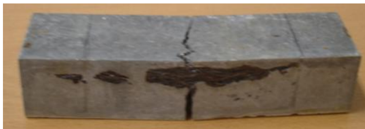
Figura 6.9 Deficiências no provete de compósito cimentício, de w/c = 0.28 , com 4% volume de fibras
