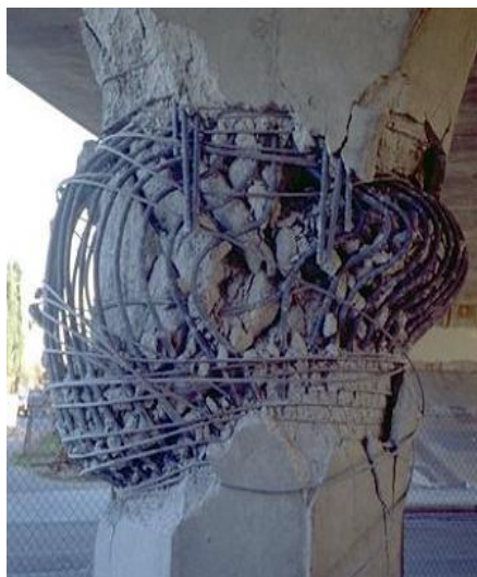
Figura 1.5 Colapso de um pilar em betão armado eventualmente por cintagem insuficiente (Northridge 1994) [ACE-MRL]
