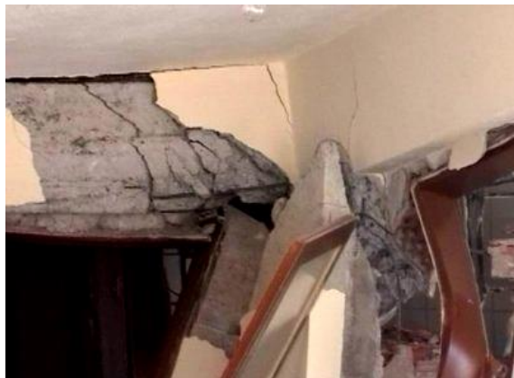
Figura 2.14 Rotura da viga por corte (Turquia, 2003) [B.O.-KOER]
