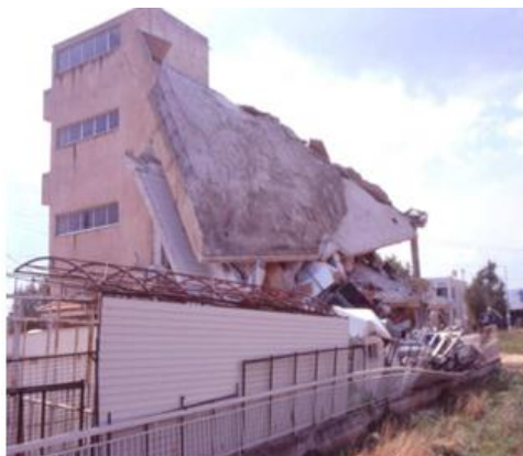
Figura 2.5 Colapso de um edifício devido aos efeitos de torção provocados pela irregularidade em planta (Atenas 1999) [Fardis (2008)]
