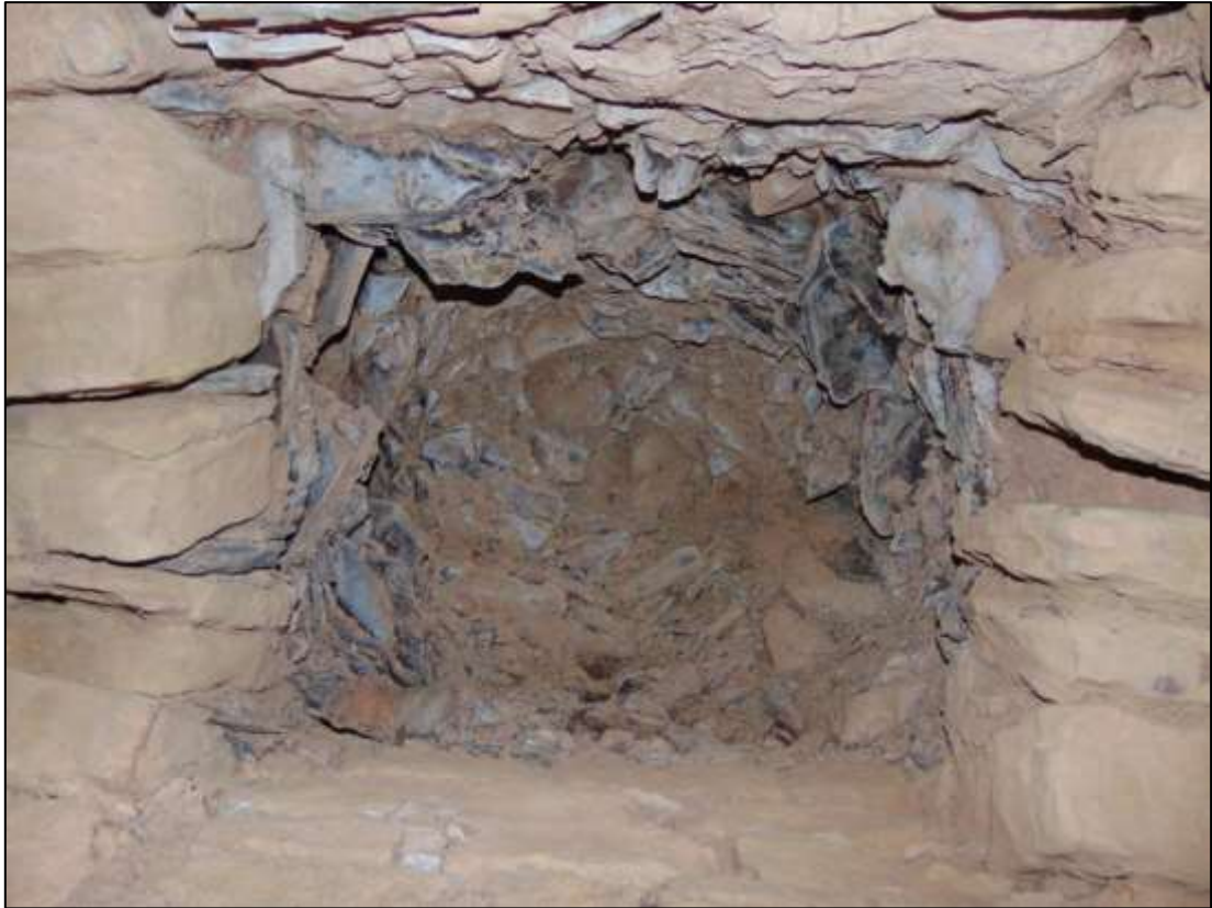
Fig. 137 - Interior do sumidouro C59, obstruído.
