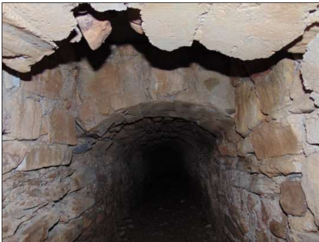
Fig. 133 - Base do sumidouro C58 visto a partir da canalização C56. É visível o restauro com cimento contemporâneo Vista Sudoeste
