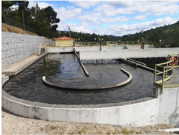
Figura 3.3 Vala de oxidação da ETAR de Vilar
