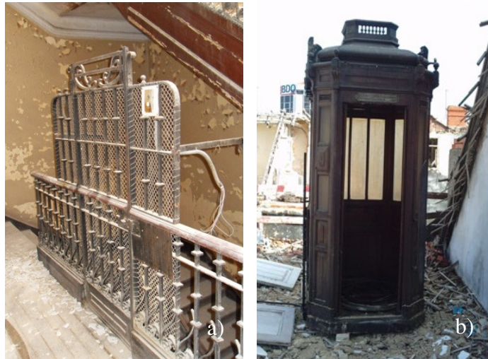
a) Sistema de elevador localizado na zona de escadas; b) Compartimento de elevador
