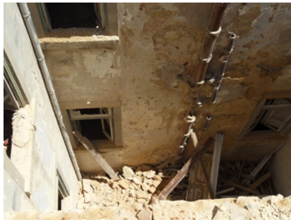
Figura 5.22 - Canalizações localizadas no saguão do edifício
