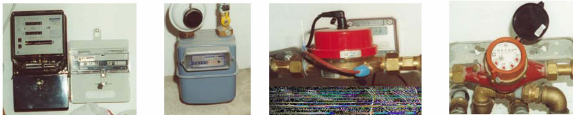
Figura 5.22. – Contadores de electricidade, gás natural, entalpia e água quente. ©TironeNunes
