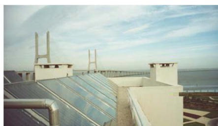
Figura 5.18. – Colectores solares. ©TironeNunes
