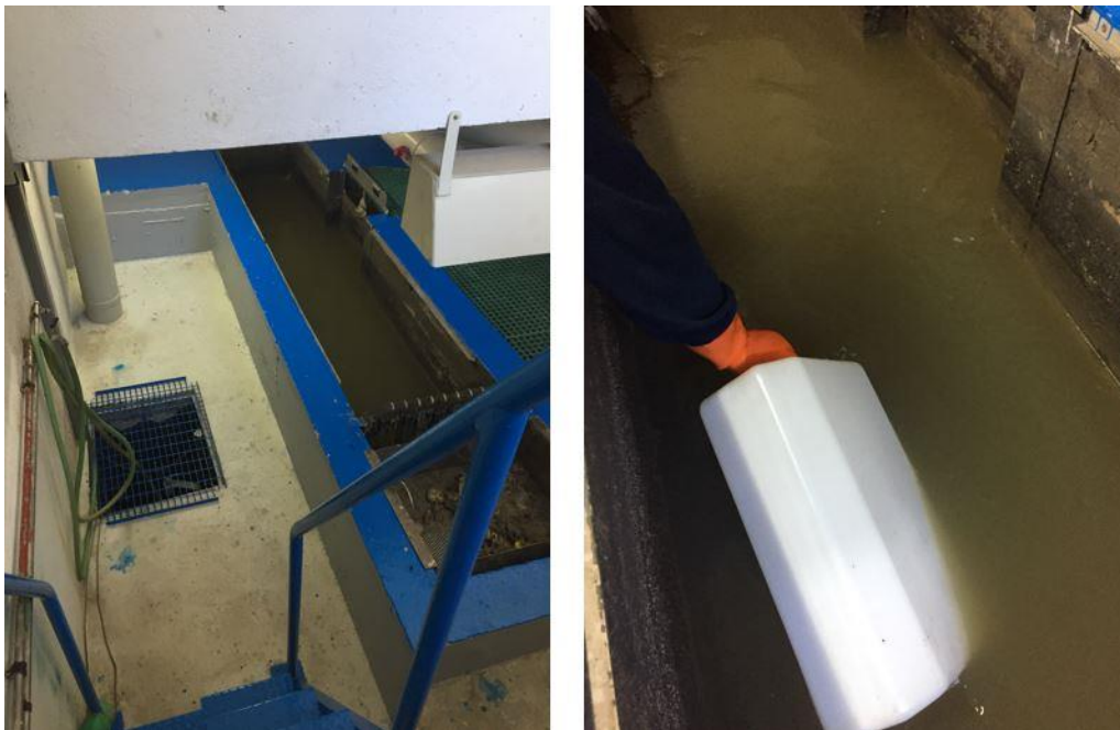
Figura 5.4 Fase I – Obra de entrada da ETAR de Fernão Ferro (à esquerda) e recolha de uma amostra de 25 L dessa água (à direita)
