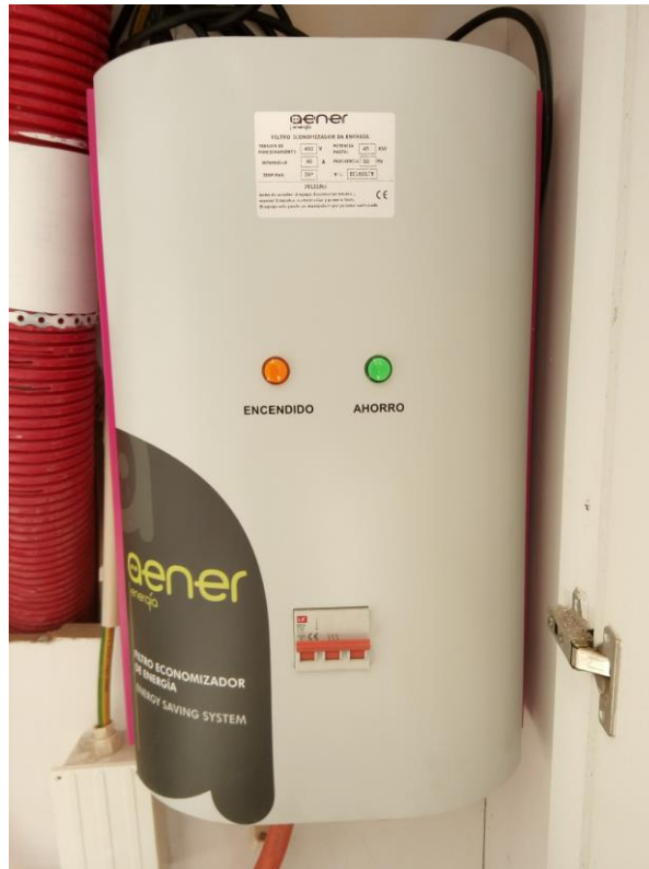
Figura 6-6: Fotografia do unidade de filtragem de energia reativa do Meu Super.
