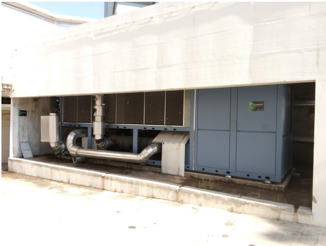
Figura 5-11: Fotografia da bomba de calor do Troiamar e Troiario.
