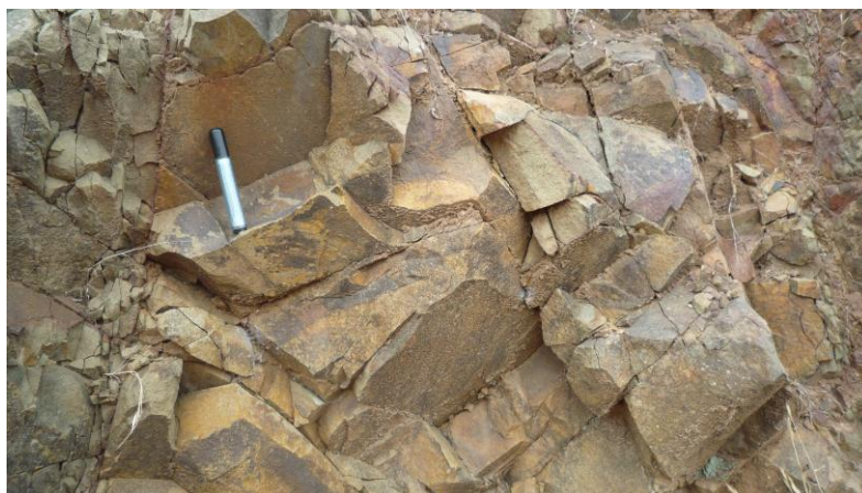
Figura 6.12 - Fracturação do talude 5
