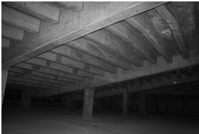
Figura 2.25: Vista Inferior da Estrutura da Plateia do Auditório do Hotel CS Golfe
