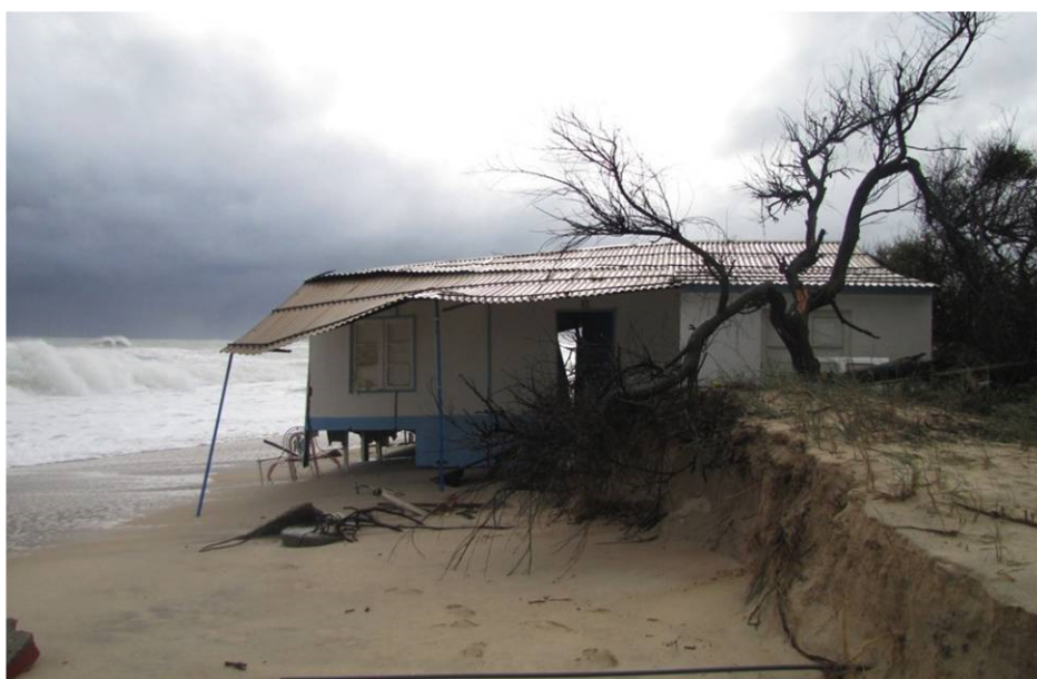
Fig. 1: Efeitos dos galgamentos oceânicos na Ilha da Armona - Núcleo da Fuseta (2010).
