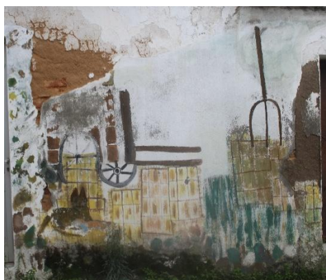
Figura 7: Exemplo de desagregação do reboco; Autor: T. Roque; Data: 2016
