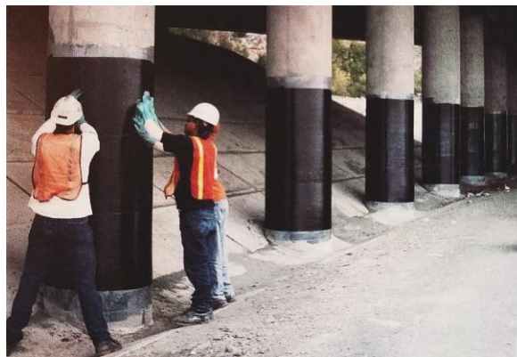
Figura 12. Reforço de 76 pilares do Departamento de Transportes de Utah (UDOT), utilizando camadas de polímero reforçado com fibra de carbono, extraído de (Dorworth et al., 2019)
