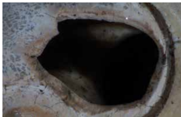
5. Fisuras en el contorno de la perforación.
