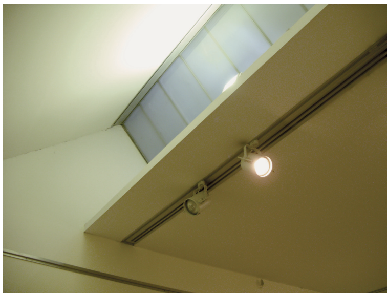
Fig. 61. Aspecto parcial do sistema de iluminação.
