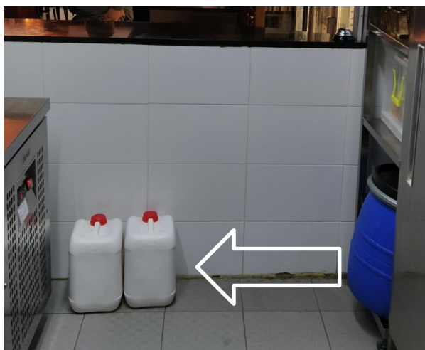
Figura 5.4 - Foto da NC relacionada aos bidões de óleo usado dispostos na zona da cozinha do estabelecimento Y.
