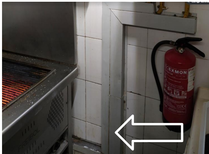
Figura 5.2 - Foto da NC relacionada a falta de higienização na parede ao lado da grelha no estabelecimento X.
