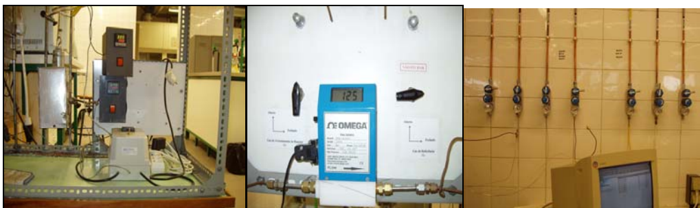
Figura 2.2 - Controladores de temperatura, caudalímetro e válvulas de gases
