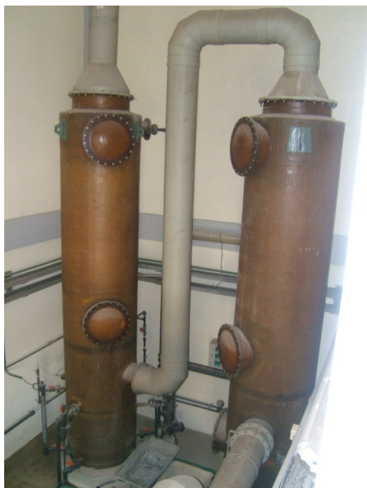
Figura 16 – Torres de lavagem inseridas no sistema de desodorização da ETAR de Sesimbra.
