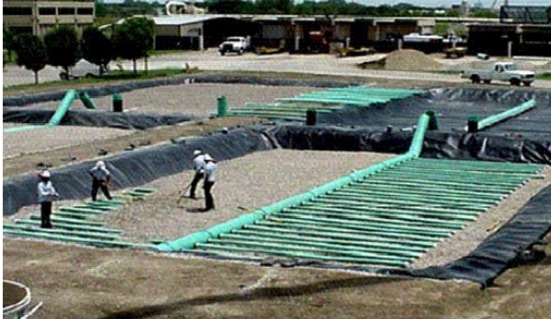
Figura 21- Colocação de sistema de suporte e distribuição de ar em ETAR, Arlington, Estado do Texas, USA (EPA , 2003)
