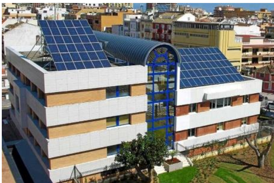
Figura 4.6- Painéis solares fotovoltaicos instalados num edifício público (fonte: Recilux, 2014).
