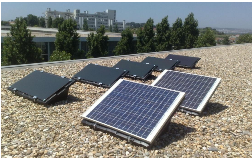
Figura 4.8 – Painéis fotovoltaicos presentes no DEE
