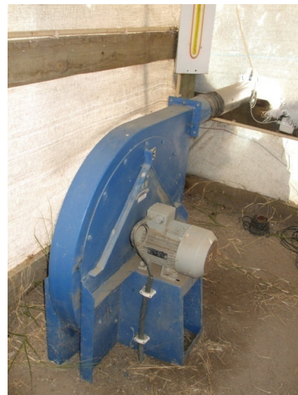
Figura 4.4 – Ventilador 2 da Instalação de Compostagem à escala de Demonstração
