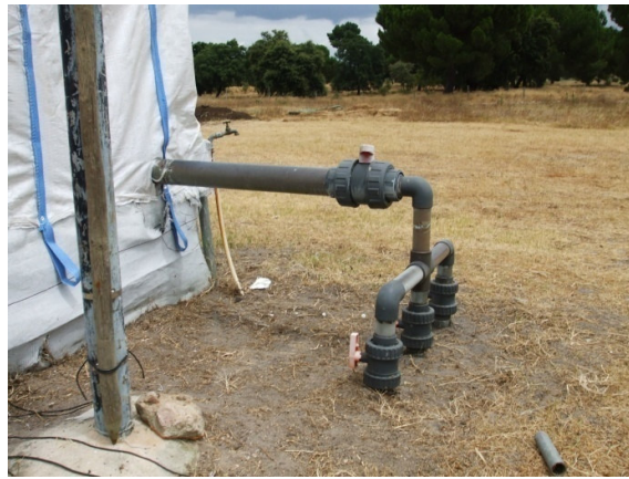
Figura 4.5 – Válvula do Ventilador 2 da Instalação de Compostagem à escala de Demonstração
