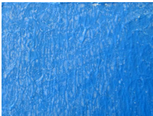
Figura 4.11 - Pormenor da Figura 4.9 b), representativo do ataque de alcalinidade sob a forma de eflorescências
