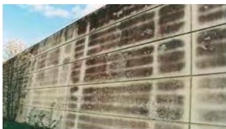
Figura 2.8 - Fungos e algas numa fachada [5]
