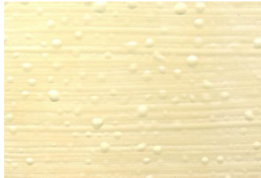
Figura 2.5 - Empolamentos presentes numa fachada [26]
