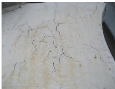
Figura 2.6 - Fissurações presentes numa parede [26]
