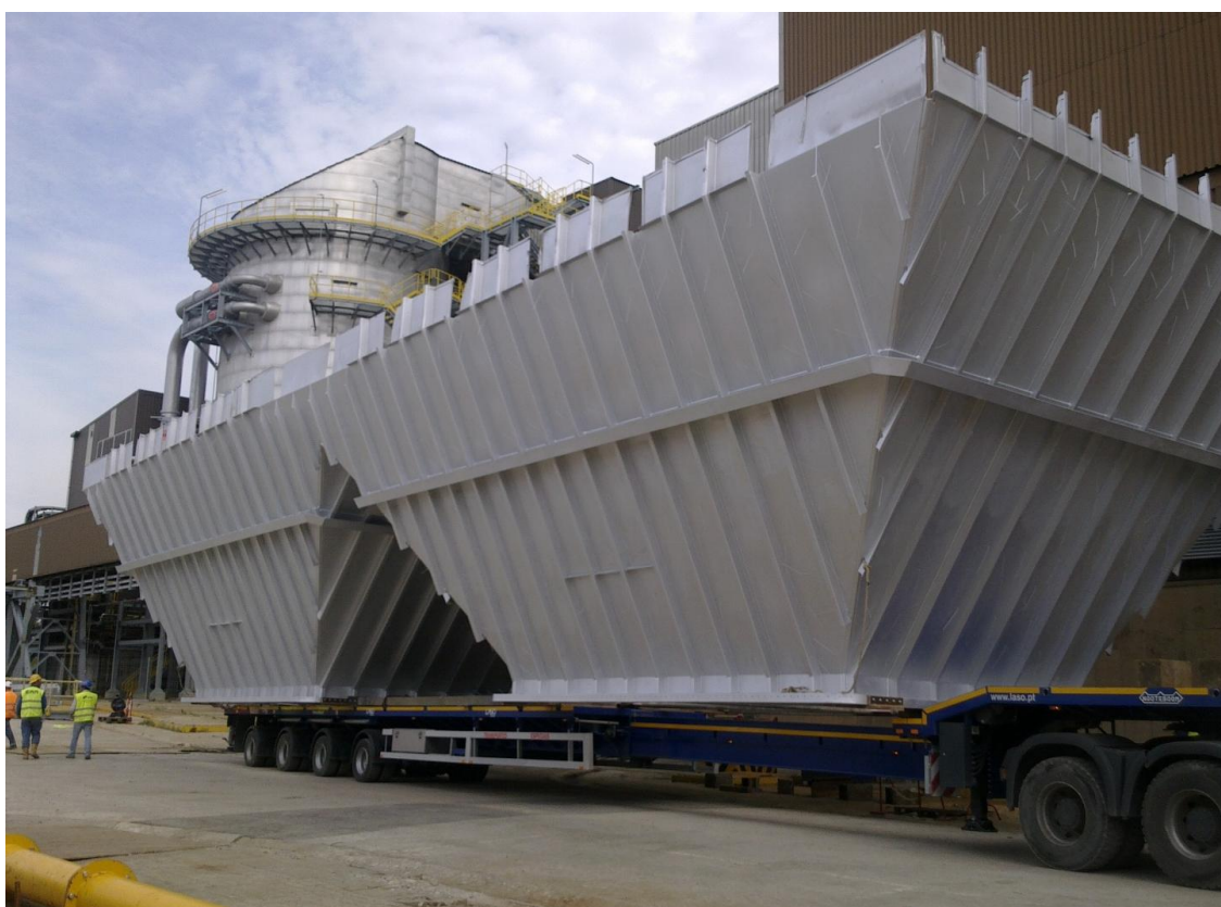
Figura 3.15 – Conduatas de ligação ao reactor na EDP em Sines
