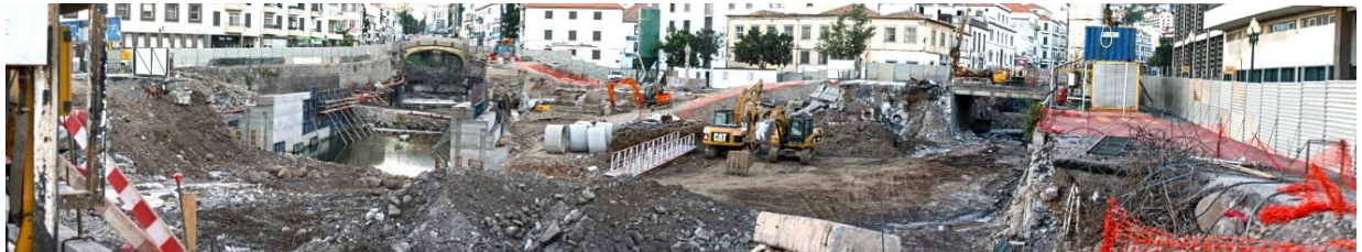
Figura 78 – Aspeto das obras de junção das fozes das ribeiras de Sta. Luzia e João Gomes. [Setembro de 2013]
