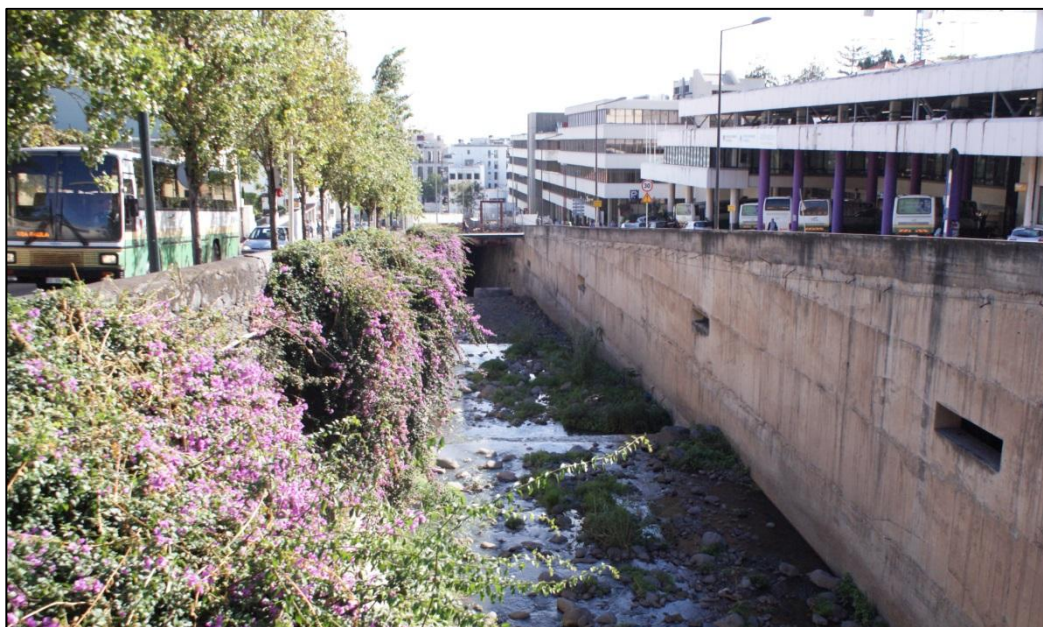
Figura 41 –Aberturas para estacionamento subterrâneo na muralha hidráulica da ribeira de São João.
