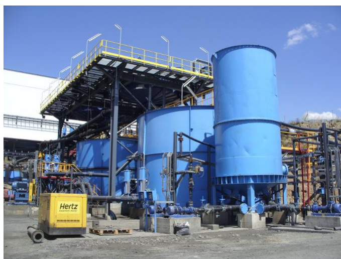
Figura 3.10: Central de rejeitado da Almina
