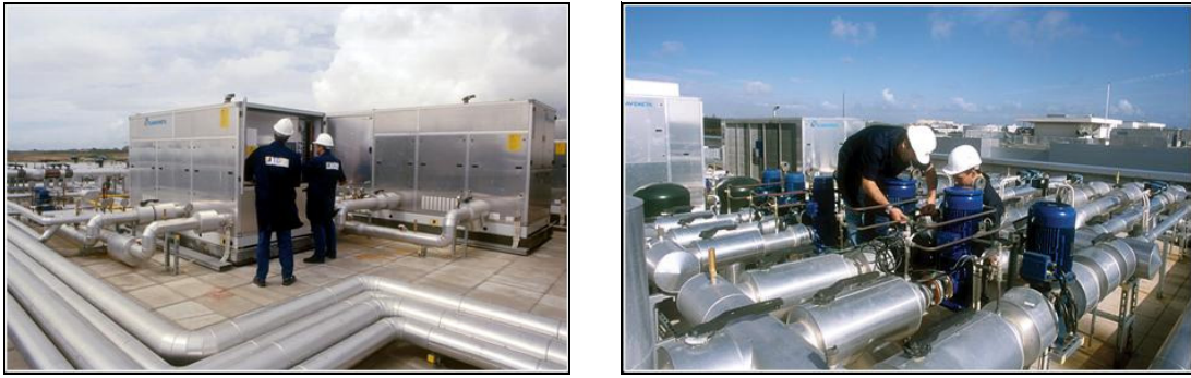
Figura 3.10 Fotografias de equipamentos da central térmica existente na cobertura.
