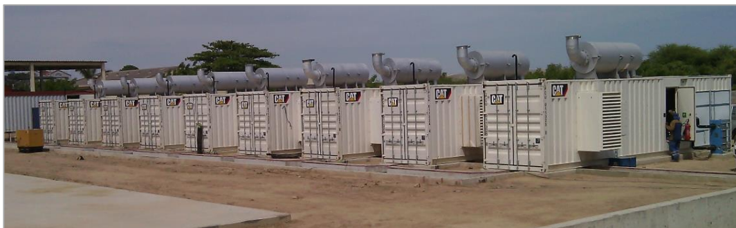
Figura 2.11 - Central de geração de energia com nove grupos geradores canopiados
