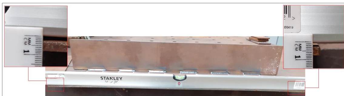
Figura 4.31 - Deformação por encurvadura (na longitudinal) do P.14
