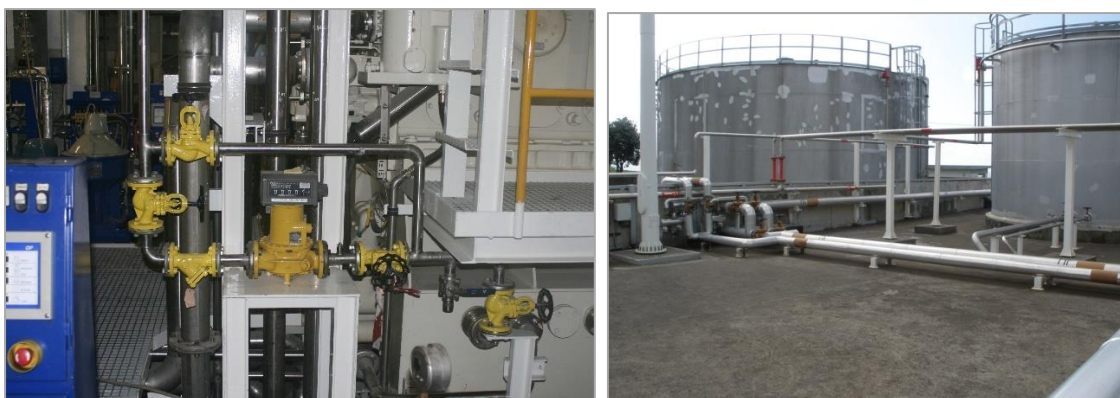
Figura 2.3 – Sistema de óleo de lubrificação (à esquerda) e parque de tanques (à direita)
