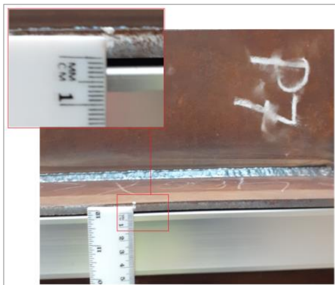
Figura 4.37 - Deformação por encurvadura da chapa principal (na longitudinal) do P.7
