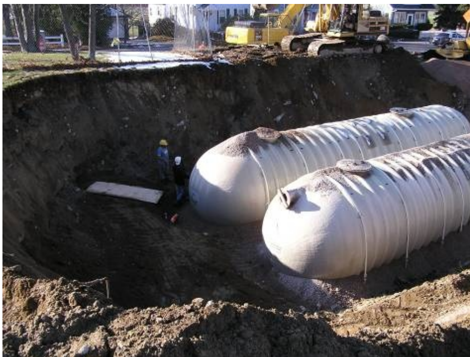
Figura 6.3 - Cisternas de armazenagem de água subterrâneas
