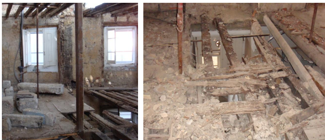
Fig. 5.18 – Degradação de vigamentos de pavimentos
