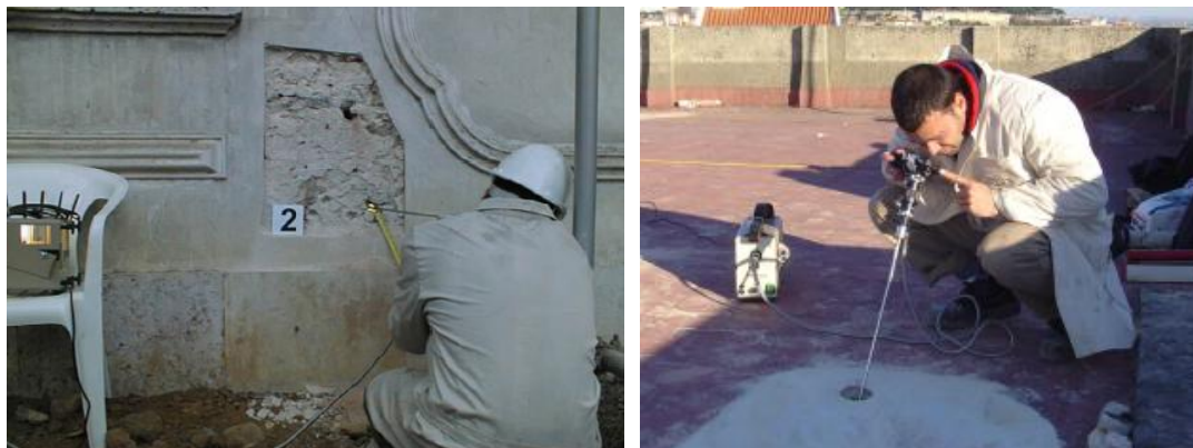
Fig. 3.21 – Inspeção de anomalias usando uma câmara boroscópica [62]
