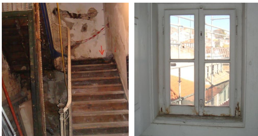
Fig. 5.20 – Corrosão em elementos metálicos
