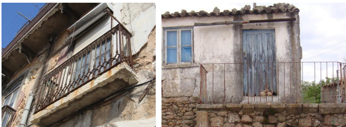
Fig. 3.9 – Oxidação de elementos metálicos (em guardas)
