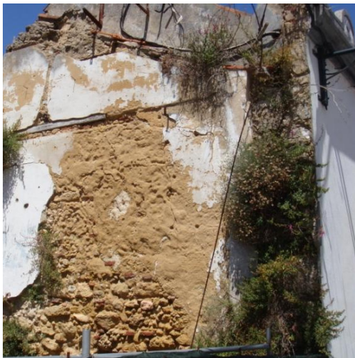
Fig. 3.4 – Desagregação da alvenaria
