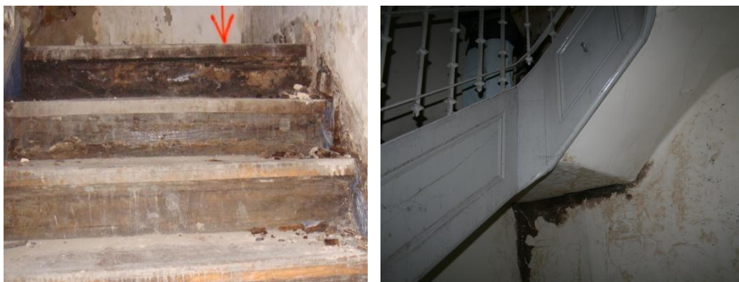
Fig. 3.7 – Proliferação de fungos por humedecimento
