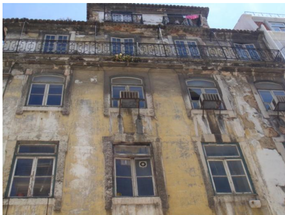
Fig. 3.10 – Degradação de vários elementos causada pelo envelhecimento e falta de manutenção dos materiais
