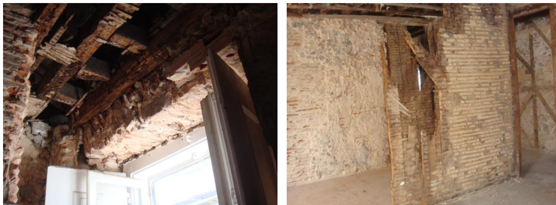
Fig. 5.12 – Degradação de elementos de madeira em paredes
