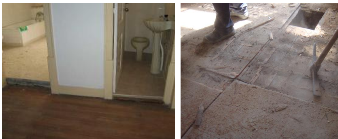
Fig. 5.19 – Existência de betonilhas e vários níveis de soalho nos pavimentos
