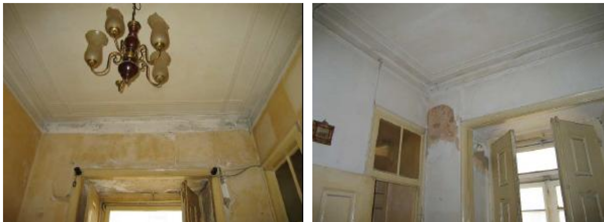
Fig. 5.14 – Desagregação em revestimentos interiores
