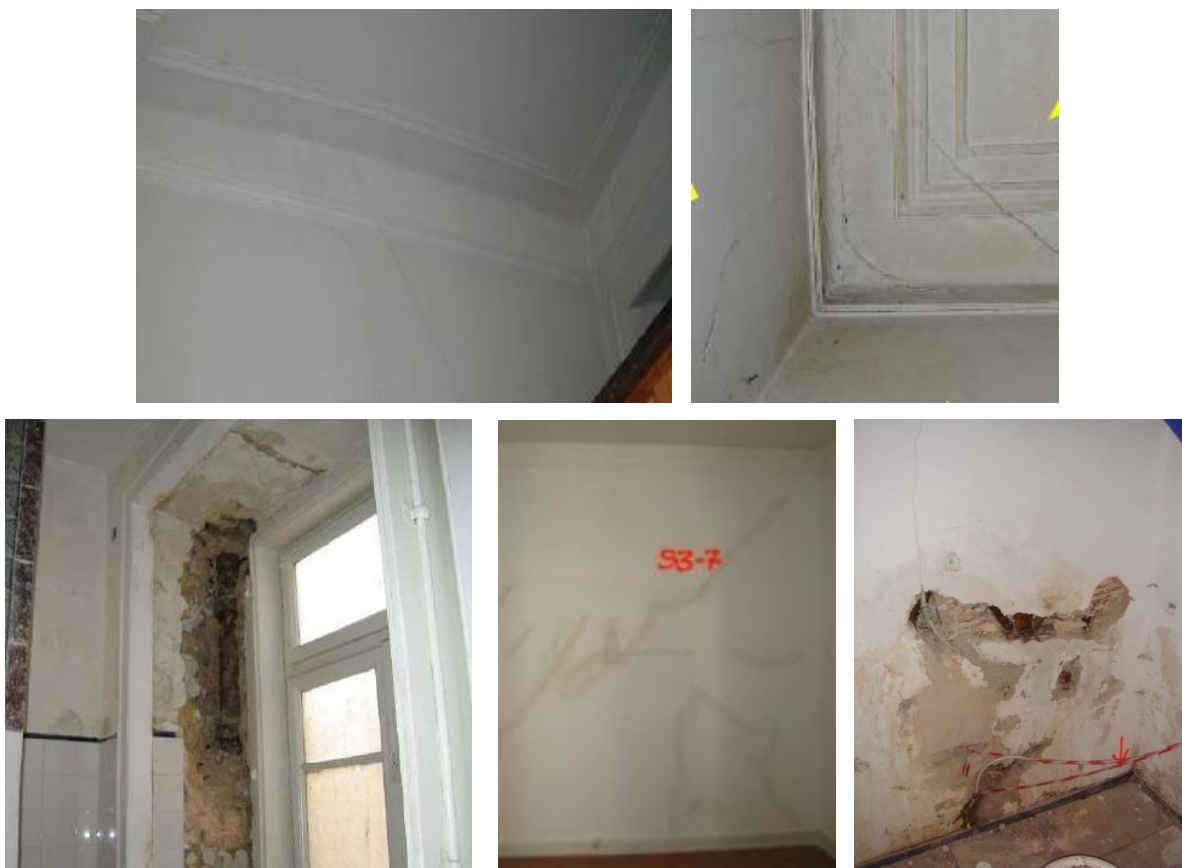
Fig. 5.11 – Fendilhação detectada no edifício [77]
