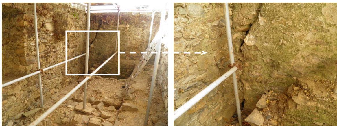
Fig. 3.3 - Fendilhação em parede de alvenaria de pedra, Igreja Matriz de Mértola [77]
