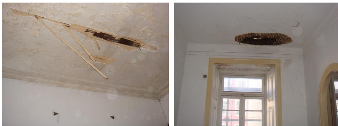
Fig. 5.17 – Desprendimento e desagregação em tectos
