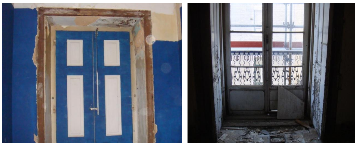
Fig. 5.15 – Caixilharia e guarnições dos vãos degradados
