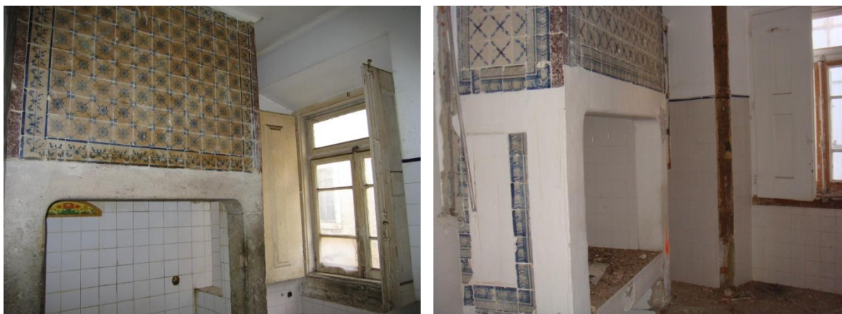
Fig. 5.13 – Degradação dos azulejos
