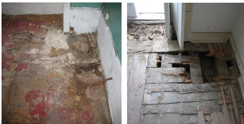
Fig. 3.8 – Apodrecimento do vigamento e revestimento dos pavimentos causado pelo humedecimento das paredes exteriores
