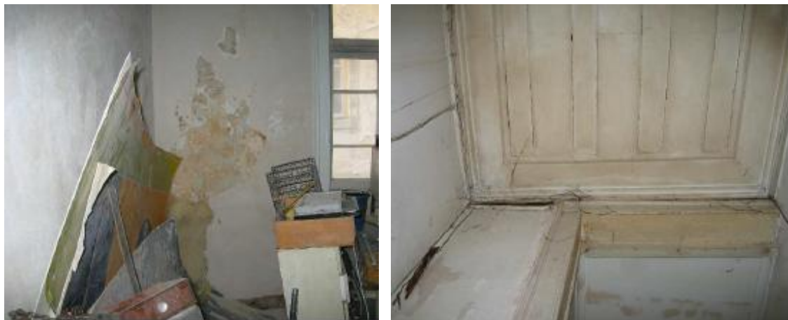
Fig. 5.16 – Eflorescências em paredes e tectos
