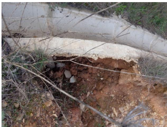
Figura 4.14 – Erosão, por ressalto da água para fora da descida de talude, na zona 3.3 do Talude 3, Fevereiro de 2014
