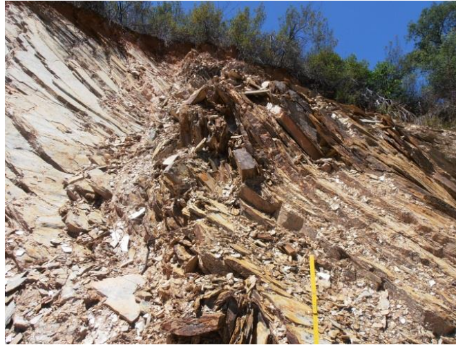
Figura 4.24 – Pormenor da zona 4.4 do Talude 4 em Junho de 2014: intensa fracturação das lajes grauvacóides
