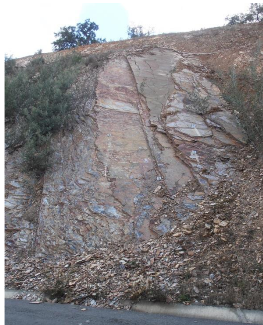
(b) Deslizamentos após obras de reabilitação (pregagens)
