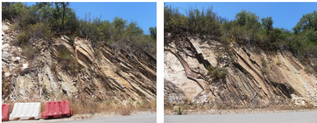
Figura 4.22 - Aspecto da zona 4.3 do Talude 4 em Junho de 2014, identificando-se lajes instáveis e roturas do tipo planar
