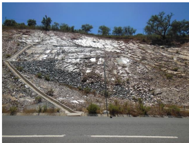
Figura 4.17 - Deslocação da máscara drenante da 5ª zona do Talude 3 observada em Junho de 2014
