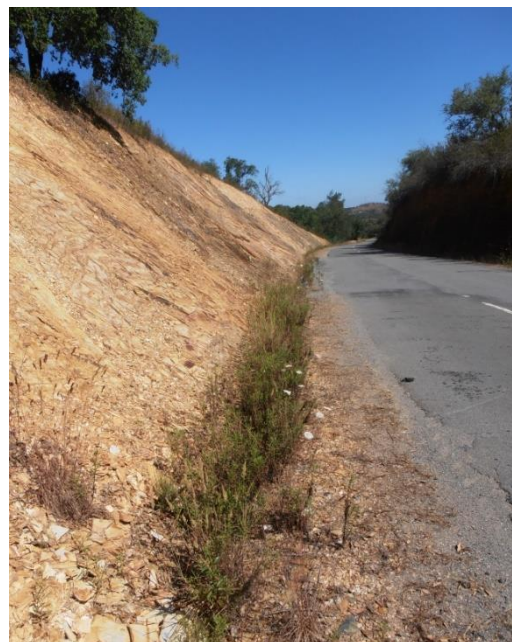
Figura 4.35 – Perfil do talude 6 em Junho de 2014: lajes de material e de vegetação rasteira na valeta não revestida e na berma
