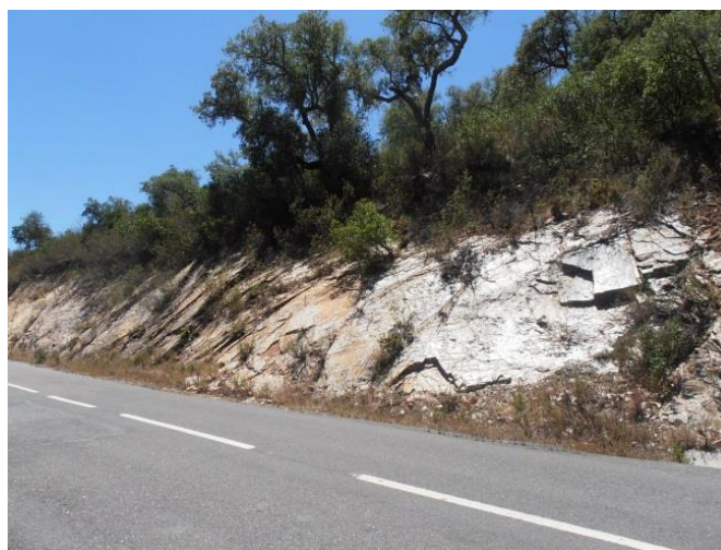
Figura 4.20 – Aspecto da zona 1 do Talude 4 em Junho de 2014 com ênfase para os deslizamentos planares
