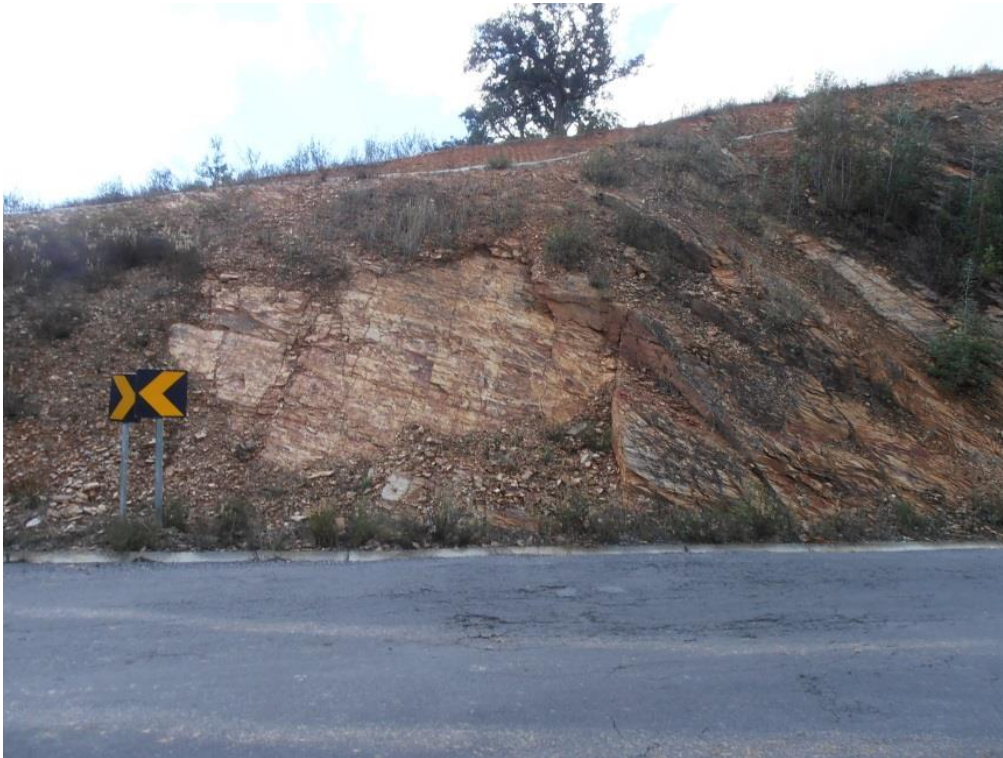
Figura 4.6 - Aspecto do talude 2 em Outubro de 2013, onde se observam roturas planares e obras de drenagem
