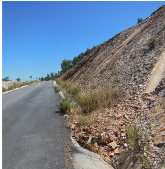
Figura 3.9 - Problemas de instabilização observados ao km 6+750, fotografias de Fevereiro de 2014
