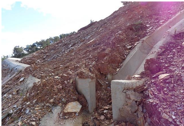
Figura 4.13 – Ravinamento de material instabilizado ocupando a banqueteta e colmatando parcialmente a drenagem na zona 3.3 do Talude 3, Fevereiro de 2014
