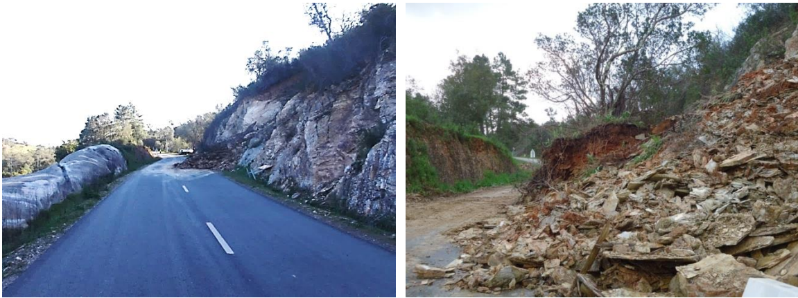
Figura 3.8 - Queda de material na via ao km 6+850 ( Monteiro, 2013)
