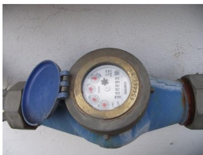
Figura 5.15 – Contador sectorial do edifício I
