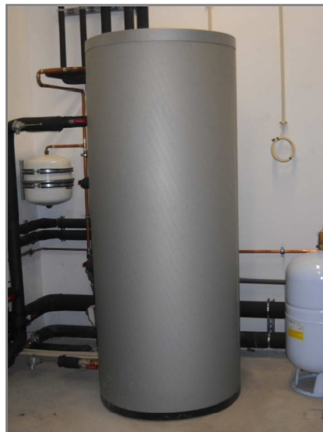
Figura 3.10. Depósito de armazenamento de água quente do Edifício Solar XXI
