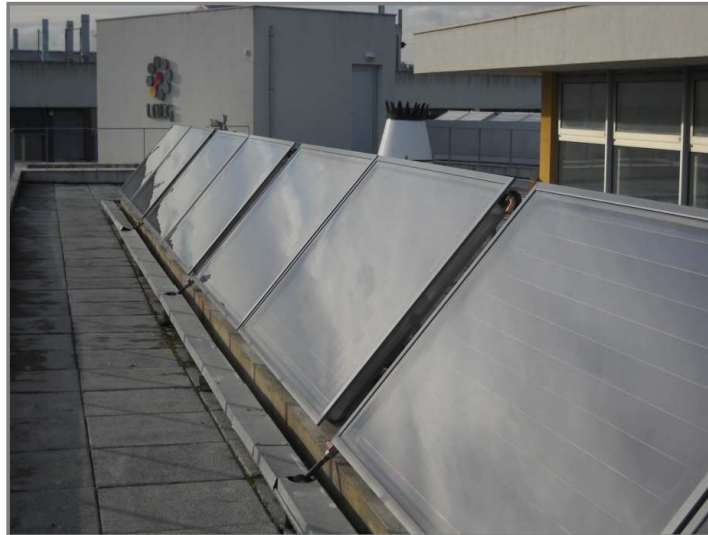
Figura 3.9. Colectores solares instalados no Edifício Solar XXI para aquecimento ambiente e água quente sanitária.
