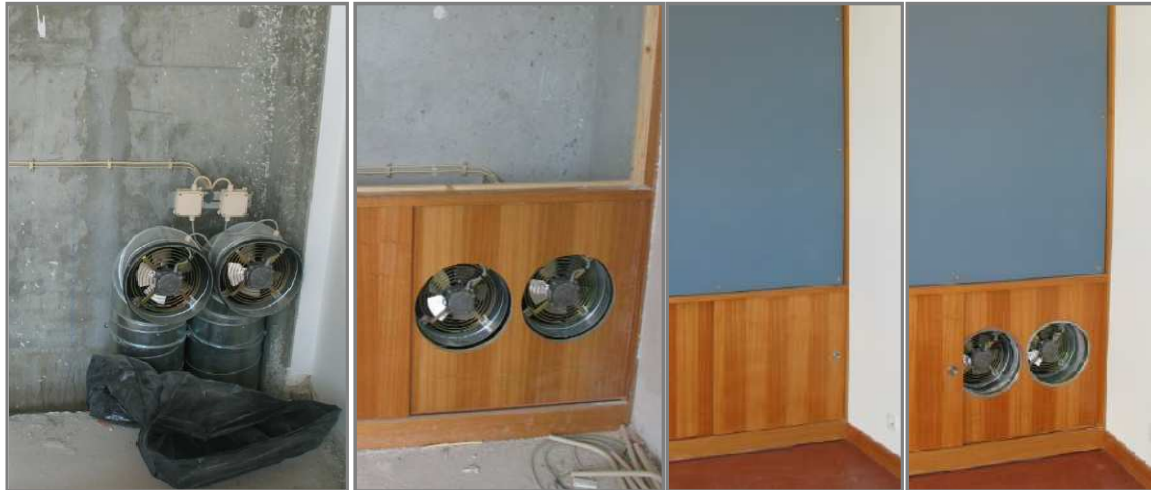
Figura 3.15. Aspectos da distribuição do ar arrefecido do sistema de tubos enterrados do Edifício Solar XXI. [27]
