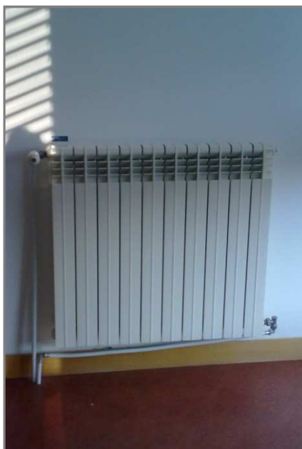
Figura 3.7. Radiadores de parede do sistema de aquecimento do Edifício Solar XXI
