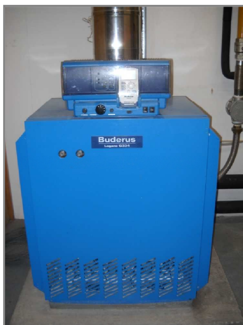
Figura 3.8. Caldeira a gás natural utilizada para aquecimento do Edifício Solar XXI.
