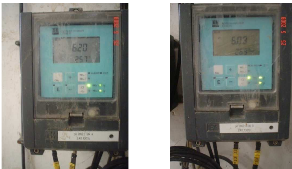
Figura 2.7- Monitorização em contínuo do pH e temperatura dos digestores anaeróbios (A e B)
