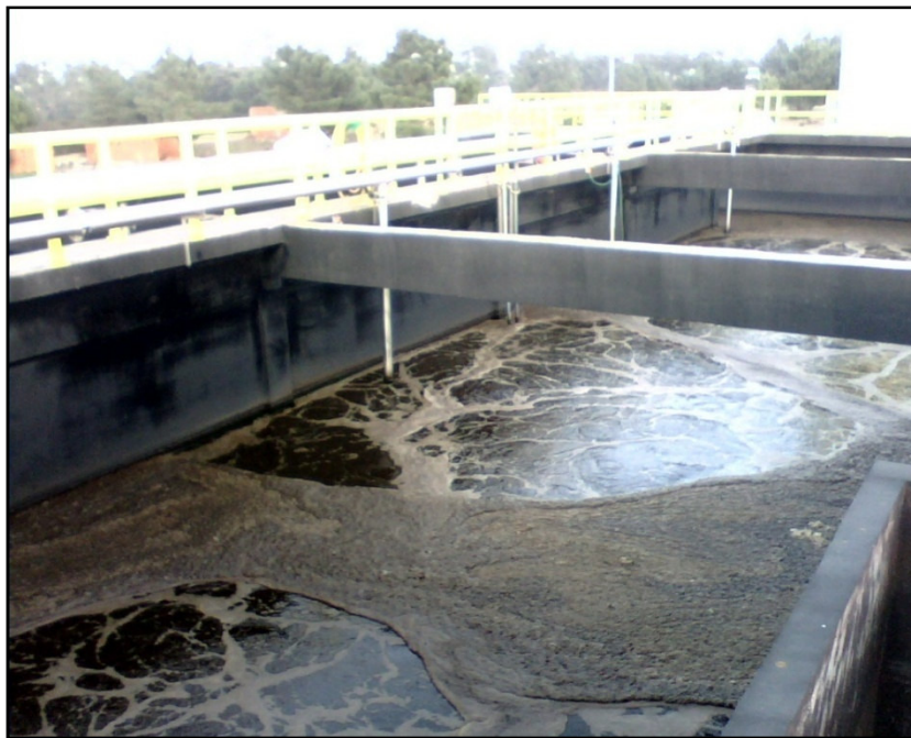
Figura 27 - A meio do tanque de arejamento (Ponto de amostragem 4)
