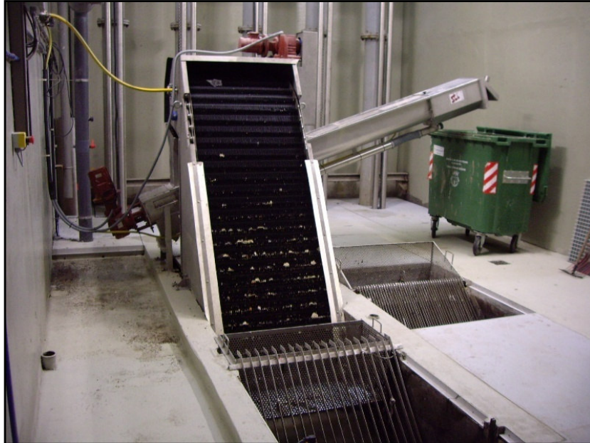
Figura 26 - Obra de entrada – step-screen (Ponto de amostragem 1)
