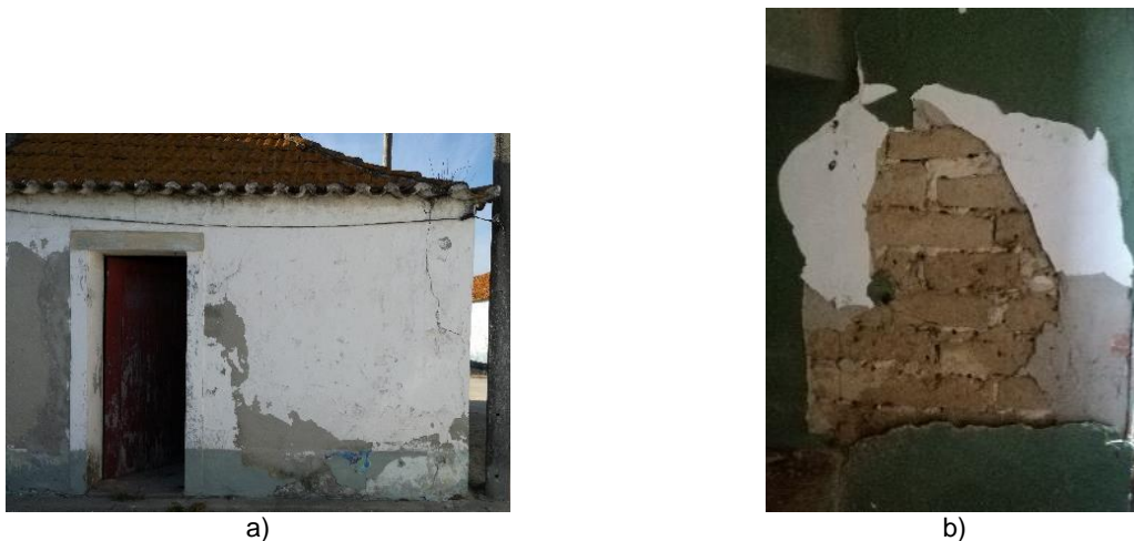
Figura 3.12 – a) destacamento de acabamento exterior face à argamassa de reboco exterior na casa 218 e b) destacamento de argamassa de reboco e acabamento interior na casa 370.
