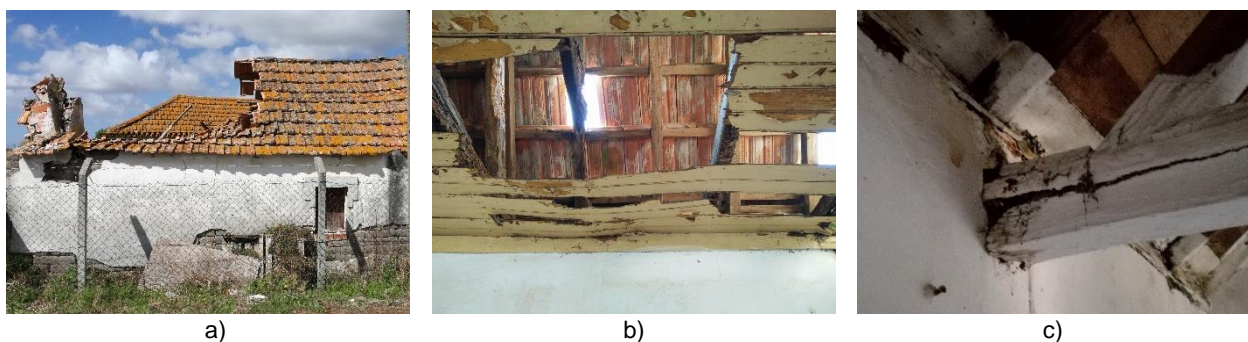
Figura 3.10 – a) queda parcial de cobertura na casa 17010; b) estrutura de cobertura danificada na casa 183 e c) vigamento de madeira apodrecido na casa 218.
