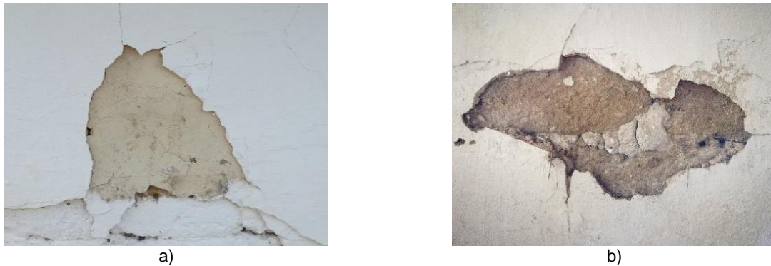
Figura 3.11 – a) destacamento de acabamento exterior na casa 227 e b) destacamento de argamassa de reboco e acabamento interior na casa 218.
