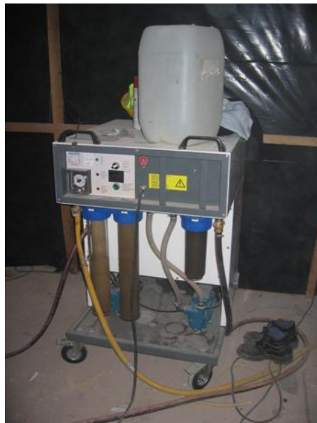
Figura 4.21 – Filtro de águas residuais com amianto
