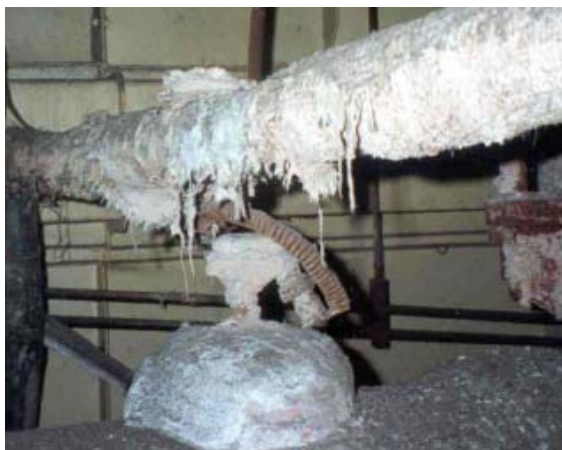
Figura A.25 – Isolamento térmico de conduta de vapor (CARIT, 2006)
