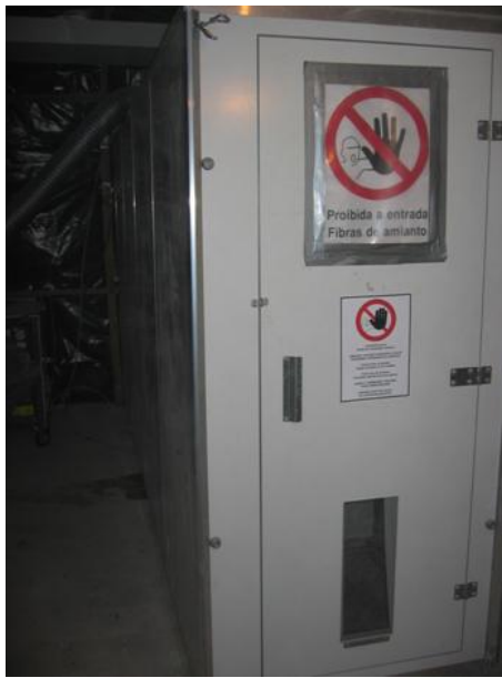
Figura 4.14 – Entrada da unidade de descontaminação
