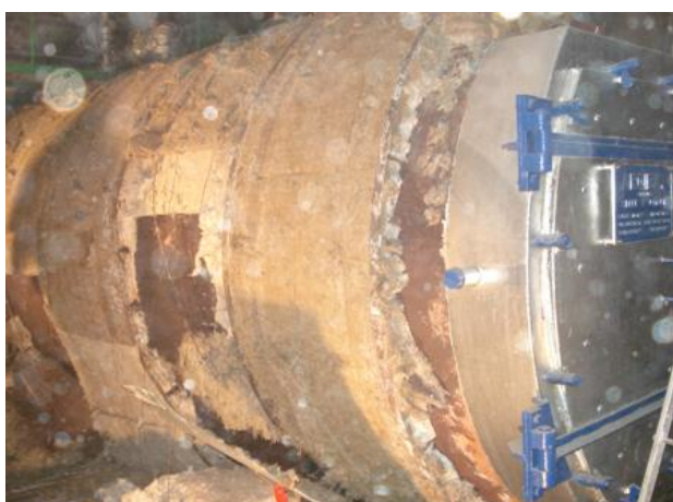
Figura A.29 – Isolamento térmico exposto de uma caldeira (Interamianto, 2007b)
