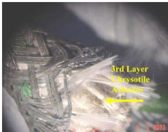
Figura A.26 – Isolamento de cabos com uma camada de amianto (CARIT, 2006)
