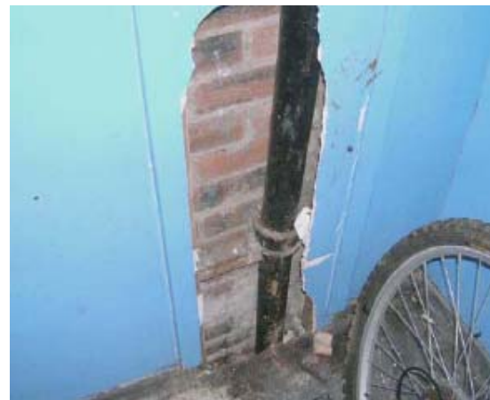
Figura A.38 – Painel de isolamento com amianto (CARIT, 2006)
