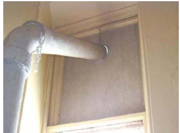
Figura A.22 – Conduto em fibrocimento com selantes de junta em cordão de amianto. A conduta atravessa um painel também com amianto (CARIT, 2006)
