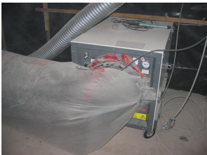
Figura 4.12 – Unidade de pressão negativa com filtros HEPA
