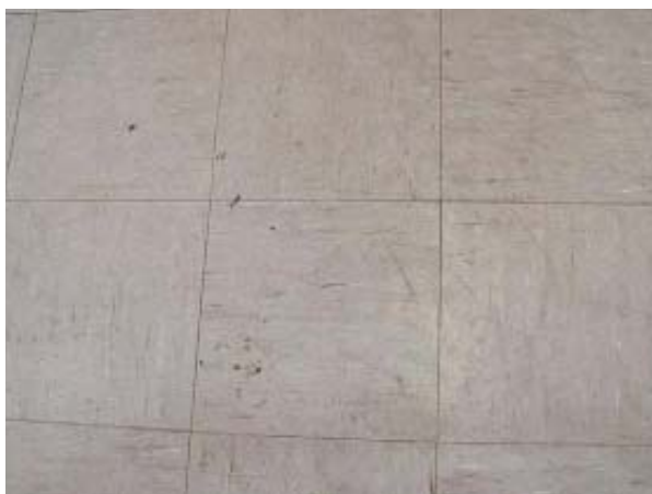
Figura A.23 – Revestimento de piso em mosaico contendo amianto (CARIT, 2006)
