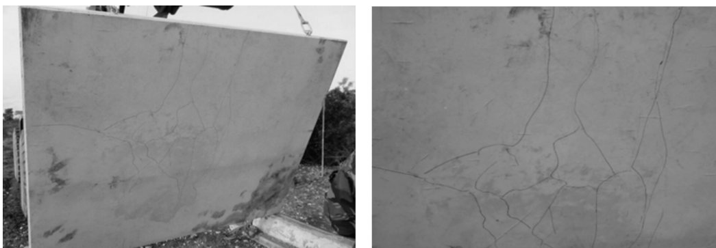
Figura 3.32: Aberturas de fendas na face inferior do painel de referência TJ-Ref - 3
