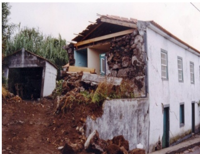
Figura 4 – Moradia na Ilha da Horta – Açores afectada pelo sismo
