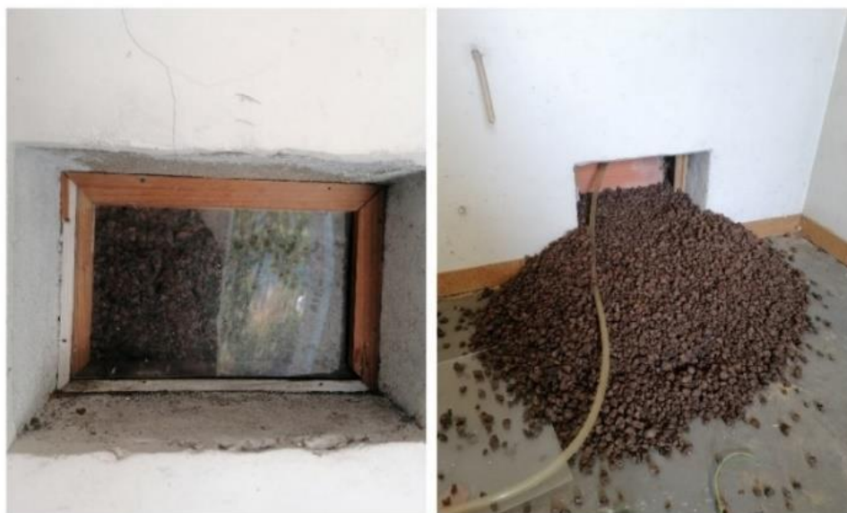
Figura 3.7 — Remoção do regranulado de cortiça das caixas de ar das paredes interiores norte e oeste.
