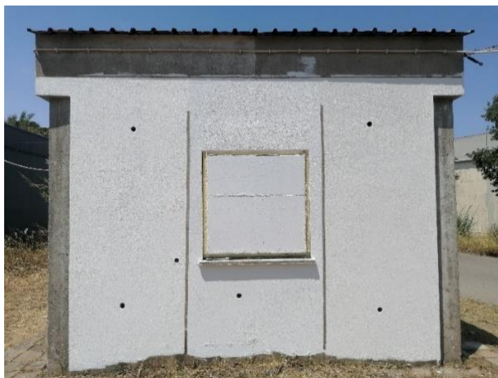
Figura 3.14 — Parede sul exterior com diferentes sistemas de pintura: da esquerda para a direita, com a tinta térmica 1 (PrN+BrT1), a tinta convencional (PrN+BrC) e a tinta térmica 3 (PrT+BrT3).
