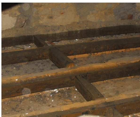
Figura 3.3 – Tarugamento em pavimento de madeira
