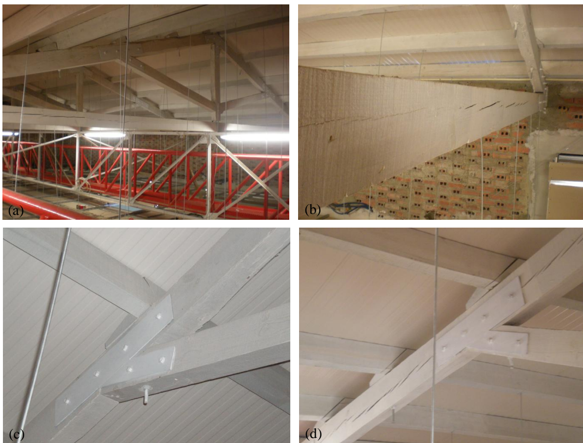
(a) – asnas da estrutura da cobertura; (b) – linha de asna reforçada na ligação com a perna; (c) – pormenor de ligação de duas peças estruturais; (d) – emendas entre peças de madeira da estrutura
