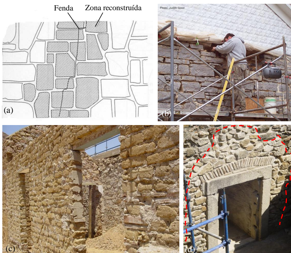
(a) – representação esquemática de zona reconstruída [64]; (b) – reposicionamento das pedras [78]; (c) - pedras de alvenaria após desmonte e reconstrução [92]; (d) – elementos de cantaria após desmonte e reconstrução [92]
