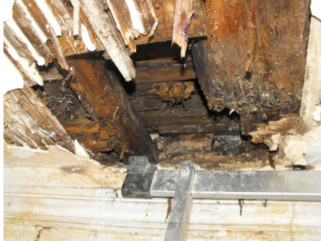
Figura 3.9 – Pavimento de madeira deteriorado pelo ataque de fungos de podridão junto a parede exterior [93]
