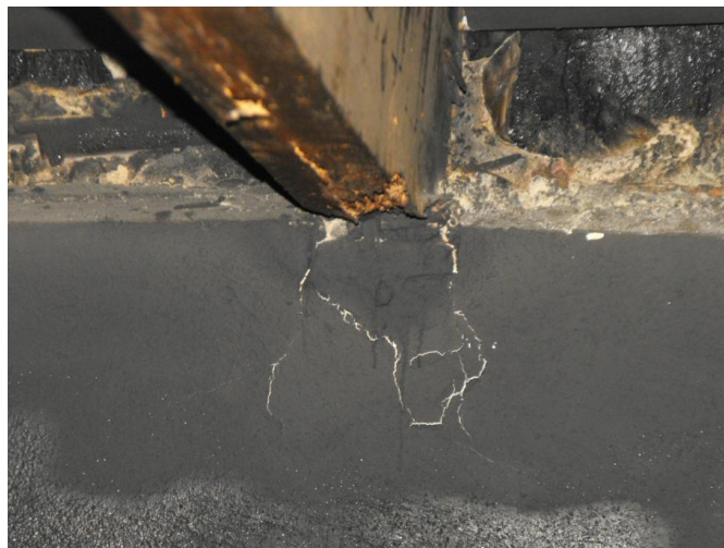
Figura 2.6 – Esmagamento localizado de parede na zona de apoio duma asna de madeira [93]
