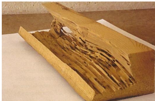
Figura 3.10 – Elemento de madeira deteriorado por ataque de térmitas [4]
