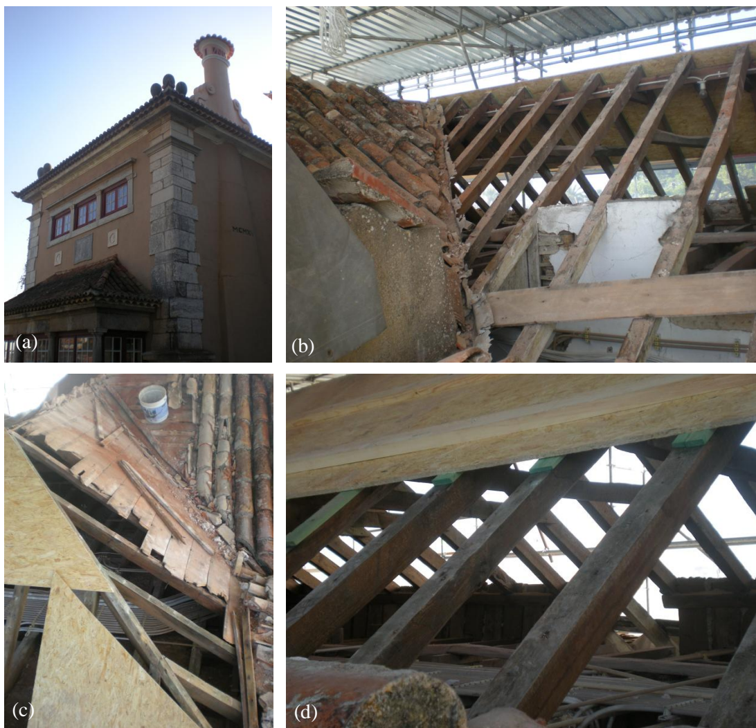
(a) – vista geral do edifício; (b) – vista nascente da cobertura a ser reabilitada; (c) – vista sul da cobertura a ser reabilitada; (d) – vista poente da cobertura a ser reabilitada
