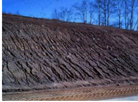
Figura 09 – Formação de sulcos devido à escorrência e transporte na vertente. Podem formar-se barrancos se nada for feito para prevenir a erosão
