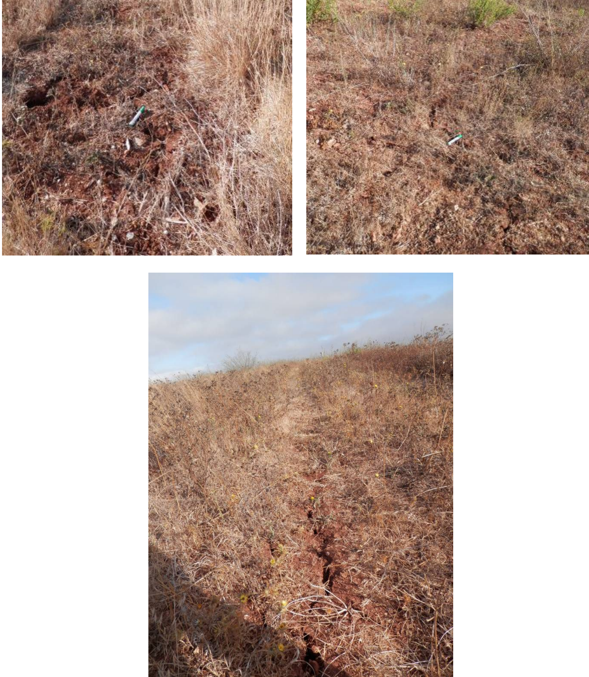
Figura 4-3 – Pormenor do sistema de fendas de dissecação no topo da lixeira (em cima); e a fenda longitudinal na crista do talude nascente (em baixo) (FFCT, 2013)
