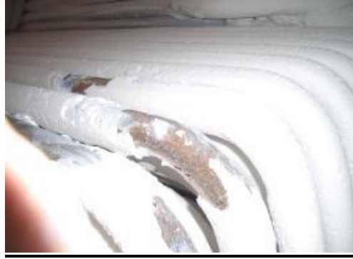
Figura 26 – Depósito de dióxido de sílica nas tubagens de uma caldeira (Tower e Wetzel, 2006a, AFT 2008)
