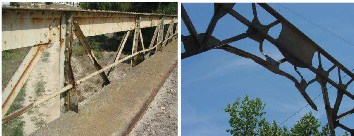
a) Deformação de viga treliçada
