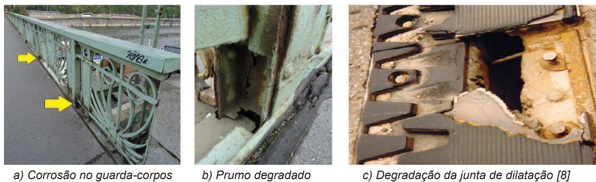
Figura 3.24 – Exemplos de anomalias na plataforma rodoviária
