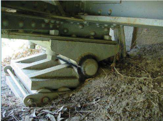
a) Aparelho de apoio com falta de manutenção [10]
