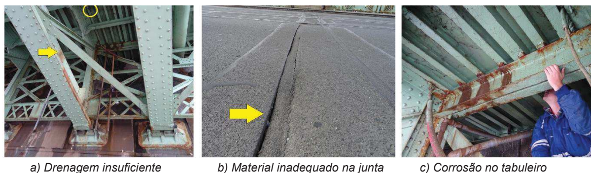
Figura 3.25 – Exemplos de deficiências na impermeabilização do tabuleiro
